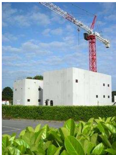
Chaufferie collective bois à Châteaubriant
